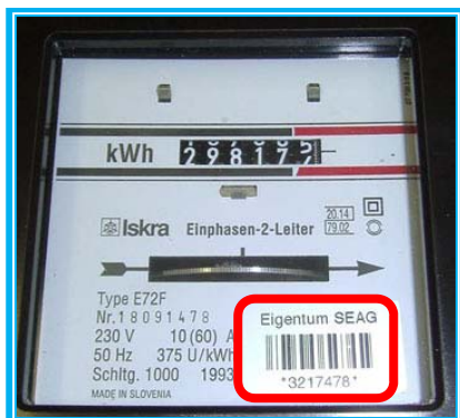
Bsp. analoger Stromzähler
